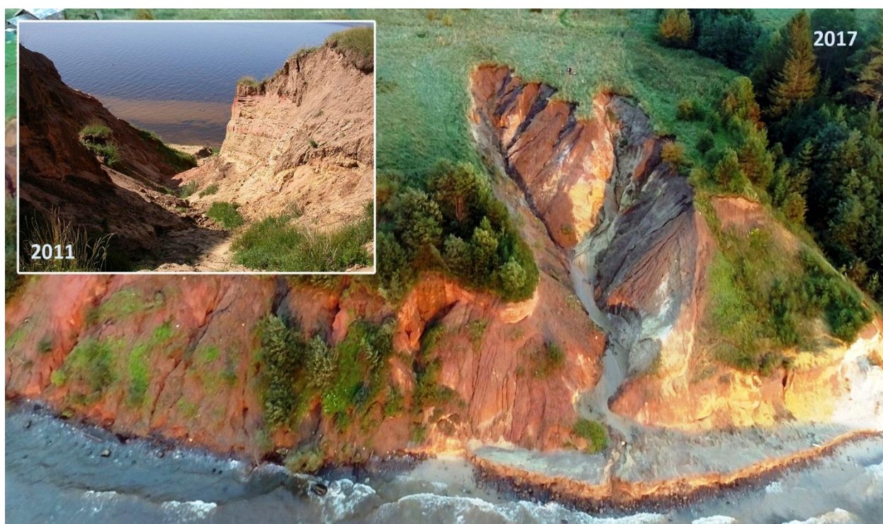
Рис. 10. Береговой овраг в районе населённого пункта Павликовская (на врезке — фото И.С. Воскресенского; снимок с вертолётa предоставлен Н.К. Максutowой)
