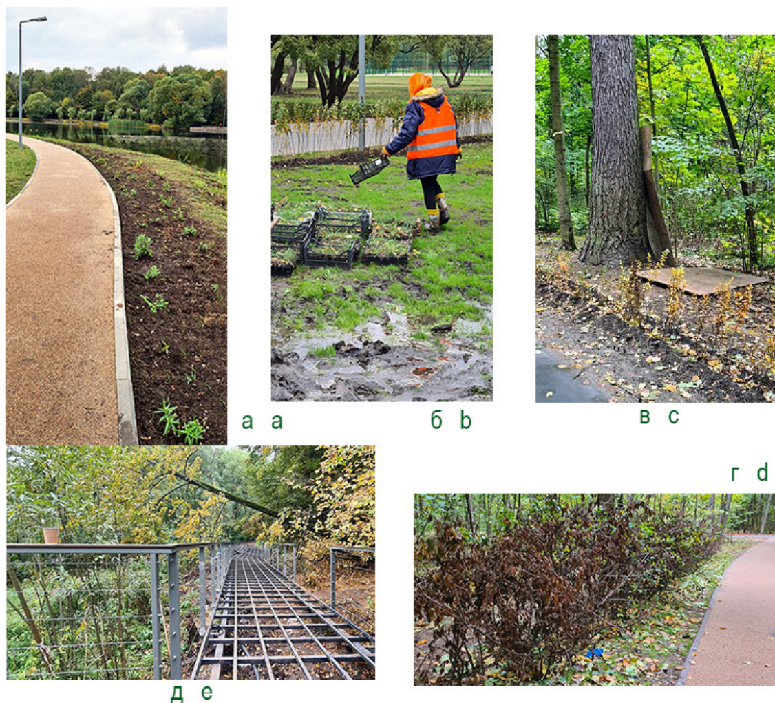
Рис. 4. Экологические нарушения при производстве работ по переустройству парка (фото автора): а) разрушительное воздействие на берег пруда, плохая приживаемость декоративных растений на месте уничтоженного луга и снятого дернового горизонта почвы, дорожка с покрытием из террасея, осветительный столб; б) процесс посадки декоративных растений; в) посаженный в старовозрастном лесу и засохший кизильник; г) засохший кустарниковый бордюр; д) металлический каркас для лестницы на сваях на обводненном склоне с опасностью оползней; на заднем плане – дерево, упавшее в процессе проведения работ
