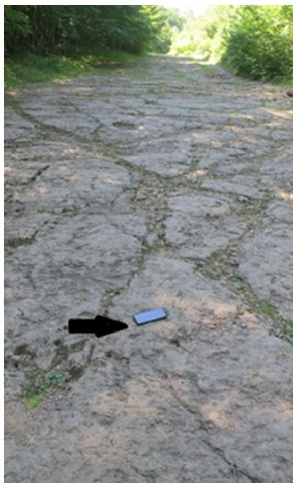
Рис. 2. Бронированный склон по трассе проектируемой автодороги. Выделенный район I (бронированные склоны, выходы доломитизированных известняков герпегемской свиты J2-3gr). Стрелка указывает на телефон (размер 7 x 14 см)
